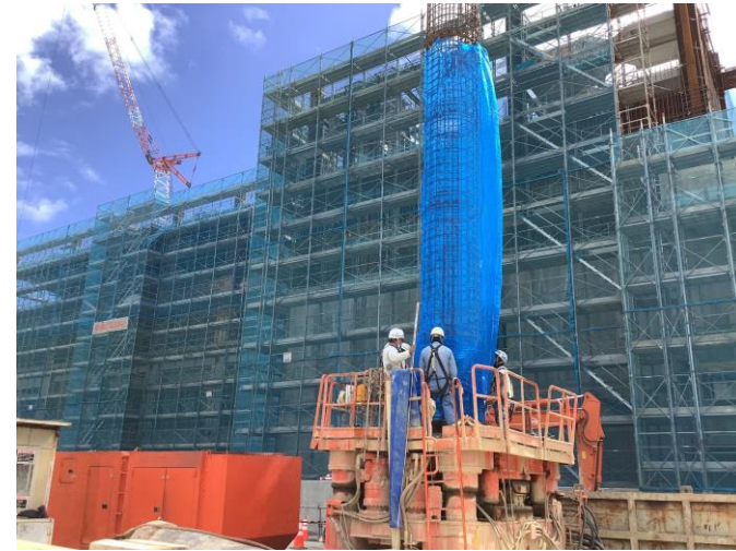
写真⑩(杭工事 A棟渡り廊下 杭の鉄筋かご挿入状況)
