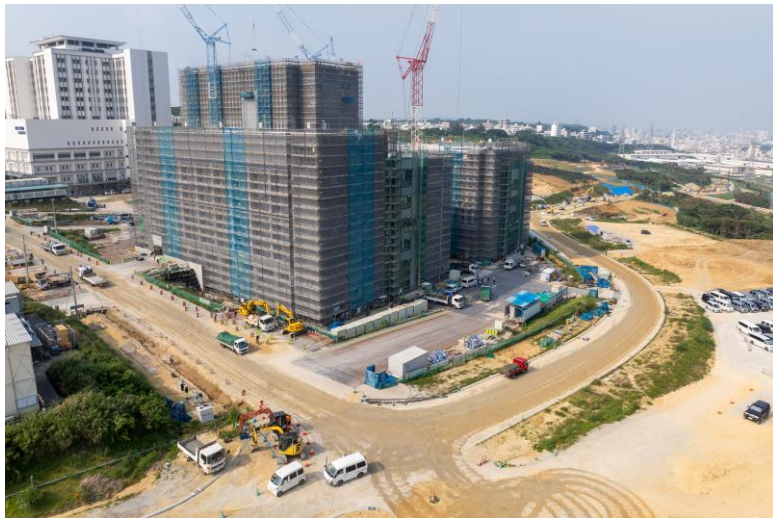
写真⑦(北北東側)
