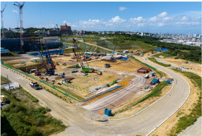
写真⑦(北北東側)
