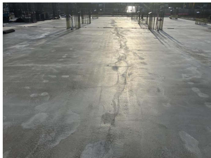
写真⑪ (B棟 コンクリート工事 2階床コンクリート打設状況)
