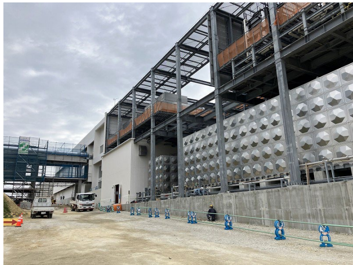
写真③（北側 設備建屋）
