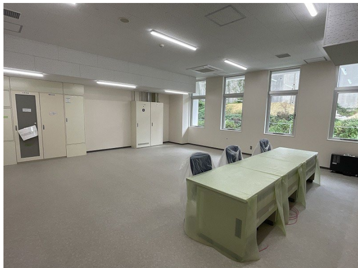
写真⑦ (エネルギーセンター 3階中央監視室)
