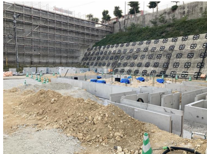
写真⑧ (エネルギーセンター配管トレンチ)
