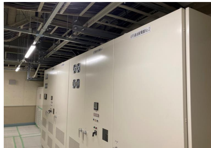
写真⑯(電気工事 受変電設備設置状況 (電気室) )
