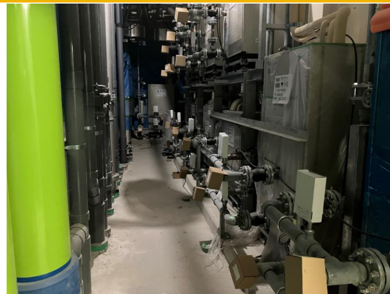
写真⑭(機械工事 機械室水熱源ユニット設置・配管施工状況)
