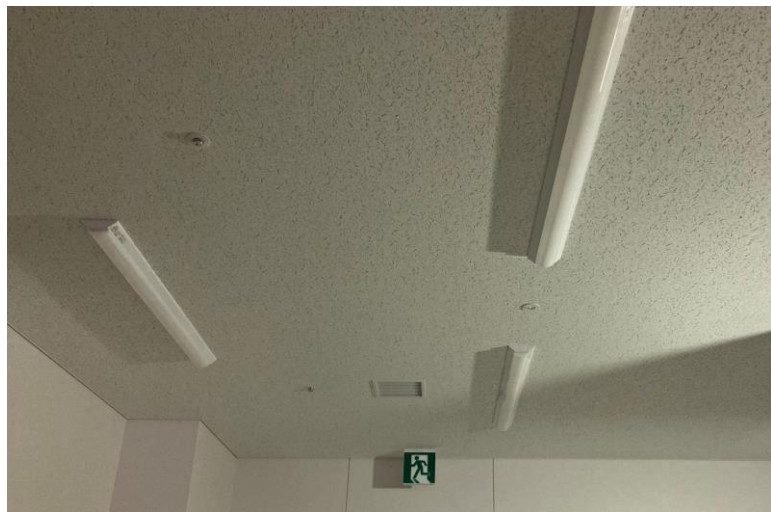
写真⑮(電気工事 機器(照明・誘導灯・自火報)取付状況)
