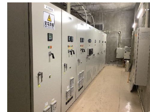
工4号館電気室（改修後）
