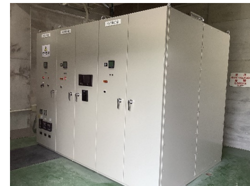
本部管理棟電気室（改修後）
