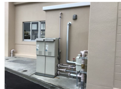
屋外 電気給湯器
