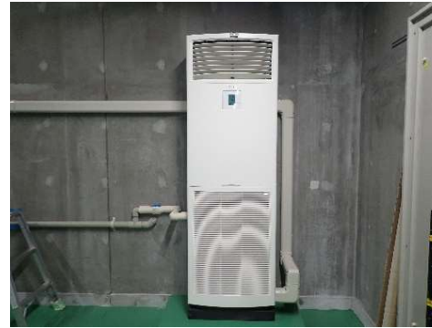
理学部校舎本館棟電気室 空調室内機
