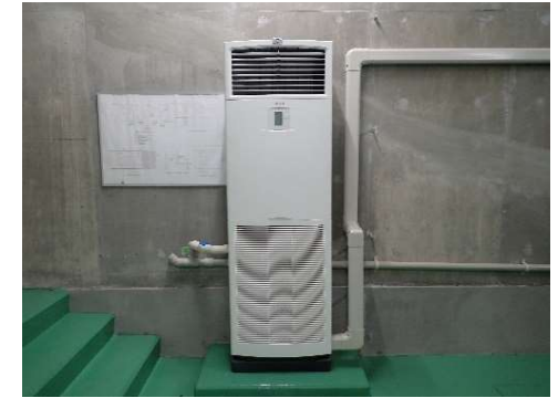
文系学部棟電気室 空調室内機
