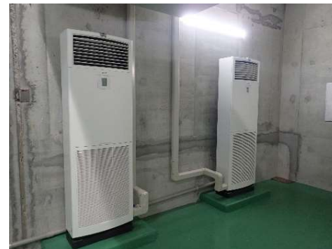
教育学部校舎本館棟電気室 空調室内機
