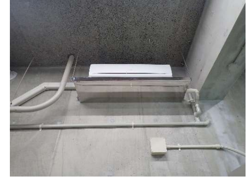
分子生命科学施設2号館電気室 空調室内機
