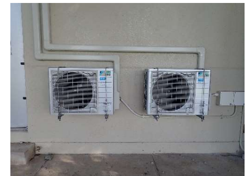
教育学部校舎本館棟 空調室外機
