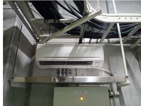
大学会館電気室 空調室内機
