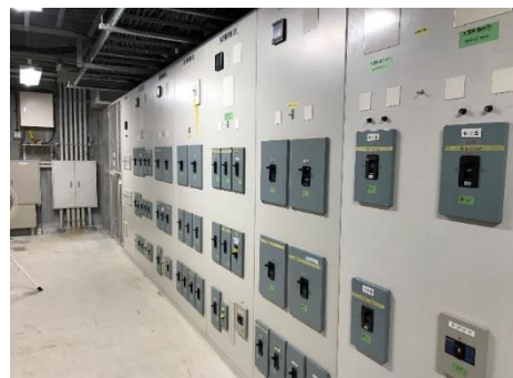
理学部校舎本館棟電気室（改修前）
