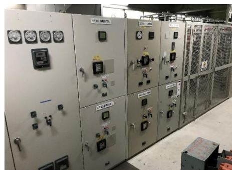
文系学部棟電気室（改修前）
