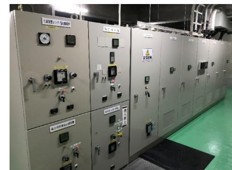
文系学部棟電気室（改修後）
