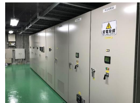
理学部校舎本館棟電気室（改修後）
