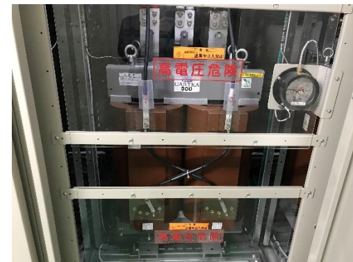
新棟男子寮 電気室 （変圧器新設）
