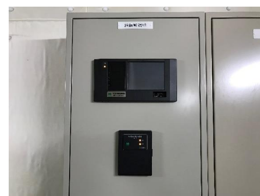
新棟男子寮 電気室 （低圧絶縁監視装置）
