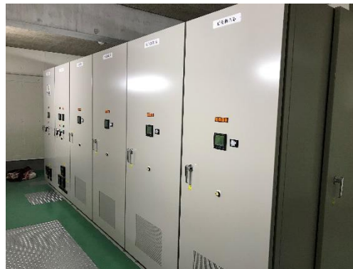
新棟男子寮 電気室 （キュービクル新設）
