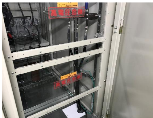
新棟男子寮 電気室 （高圧ケーブル新設引込）
