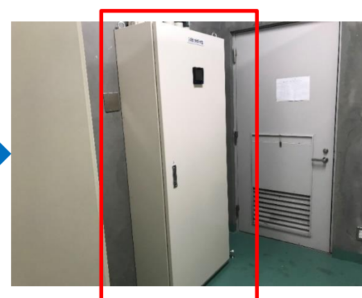
地域国際学習センター電気室 (幹線分岐盤新設後)
