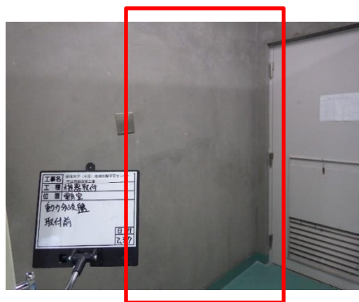
地域国際学習センター電気室 (幹線分岐盤新設前)
