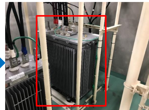
地域国際学習センター電気室 (変圧器更新後)
