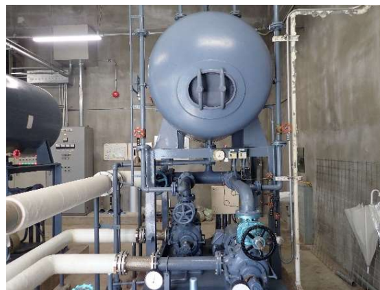
設備機械室棟 上水 給水ポンプ 改修前
