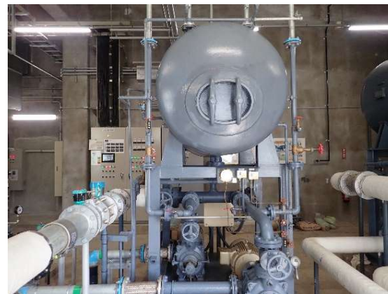
設備機械室棟 中水 給水ポンプ 改修前
