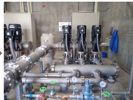
設備機械室棟 上水 給水ポンプ 改修後
