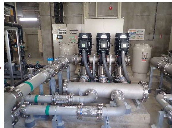
設備機械室棟 中水 給水ポンプ 改修後
