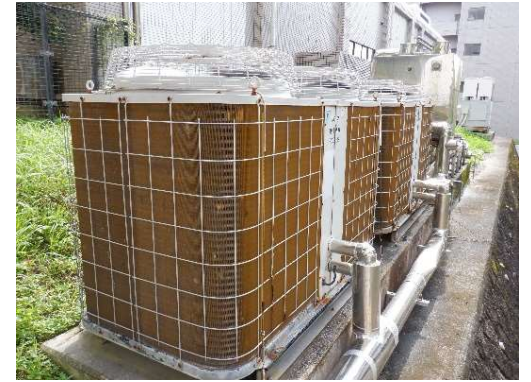
改修前 室外機（経年19年）
