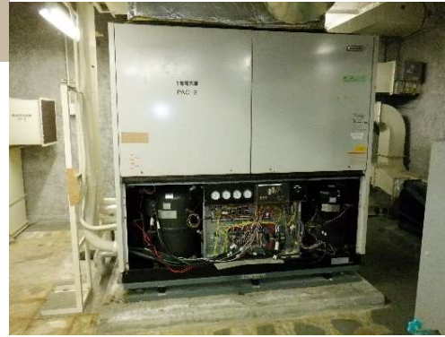
改修前 室内機（経年19年）
