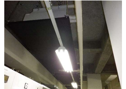
改修後 電気室内
