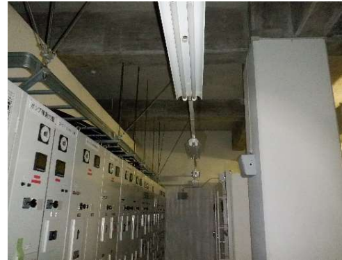
改修前 電気室内
