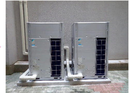
理系複合棟 空調室外機 (改修後：1階)
