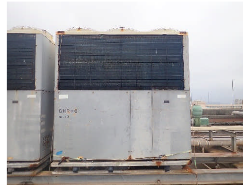
理系複合棟 空調室外機 (改修前：屋上)
