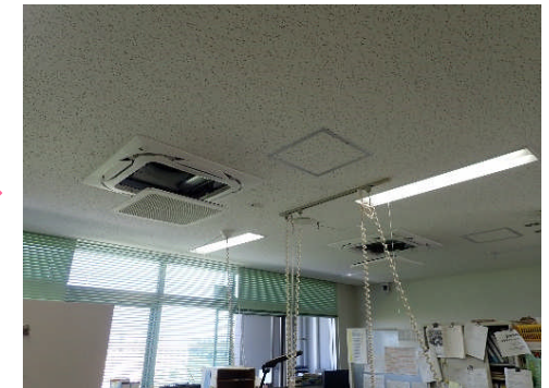
理系複合棟 空調室内機 (改修後：5階事務室)
