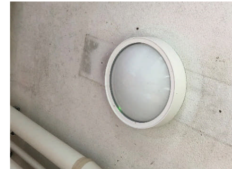
共用部 階段灯（改修後）
