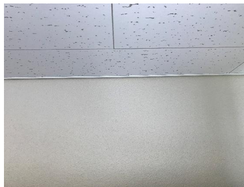
手元開閉器設置前
