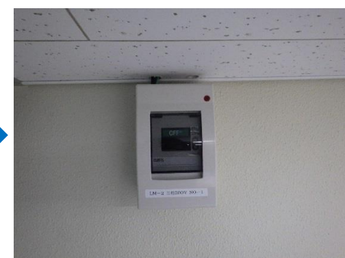
手元開閉器設置後
