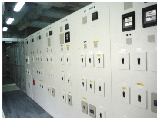
工2号館配電盤（改修前）
