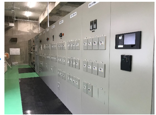
工2号館配電盤（改修後）
