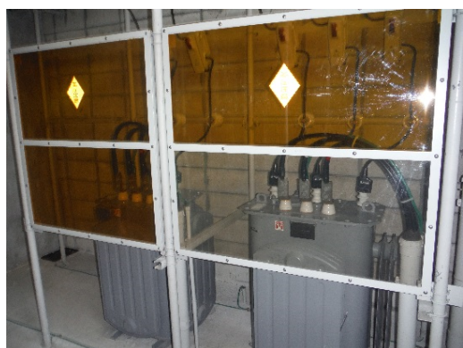
技術教育棟変圧器（改修前）
