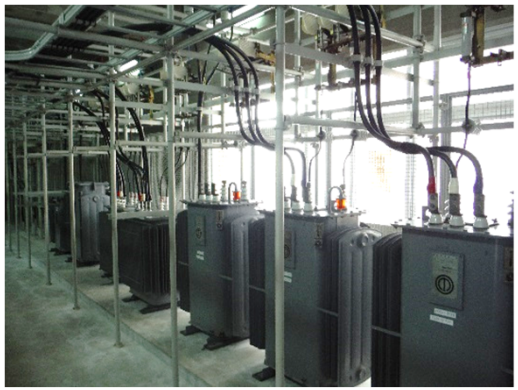
工2号館変圧器（改修前）
