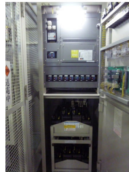
中央設備機械室直流電源設備 （改修前）
