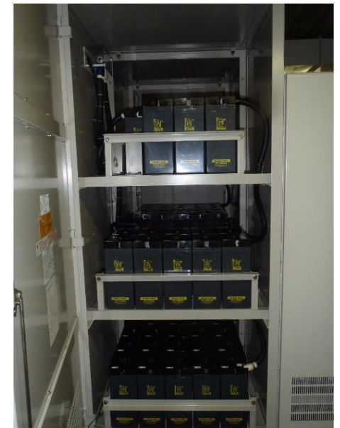
附属直流電源設備 （改修後）
