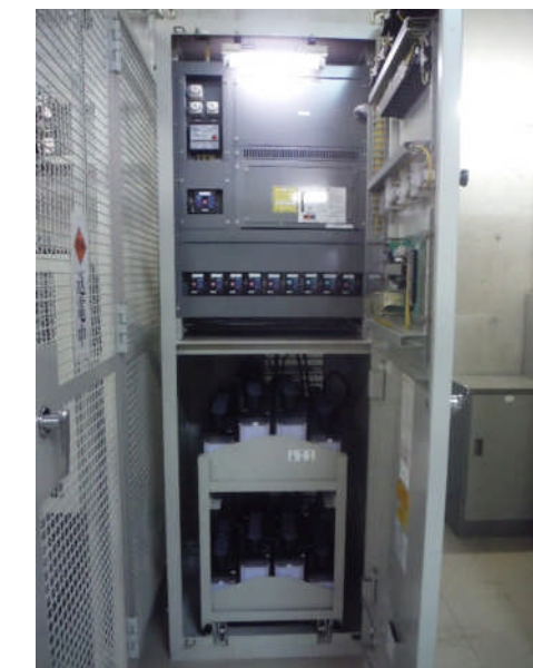
中央設備機械室直流電源設備 （改修後）
