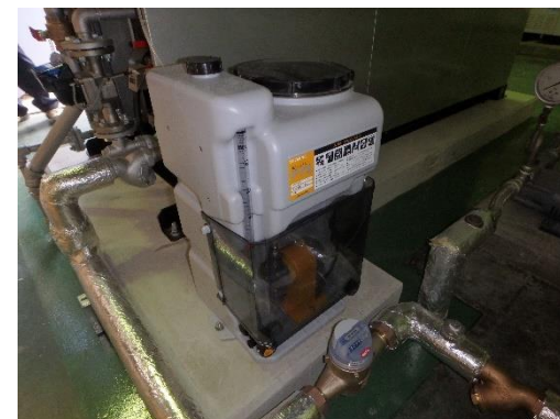
薬注タンク・ポンプ
