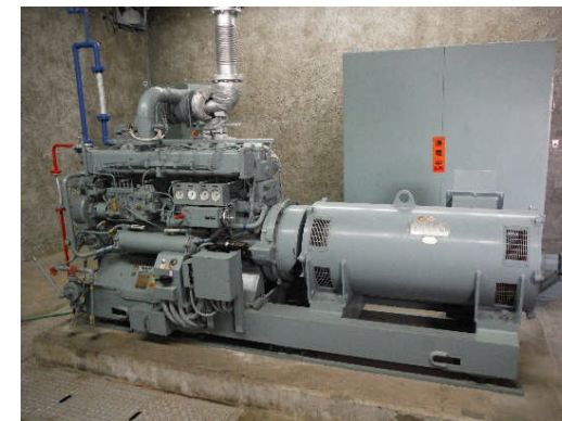
非常用発電機（改修前）
