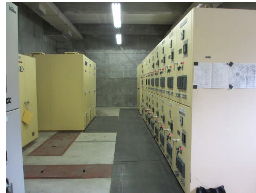
高圧配電盤（改修前）
