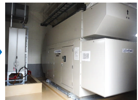
非常用発電機（改修後）
