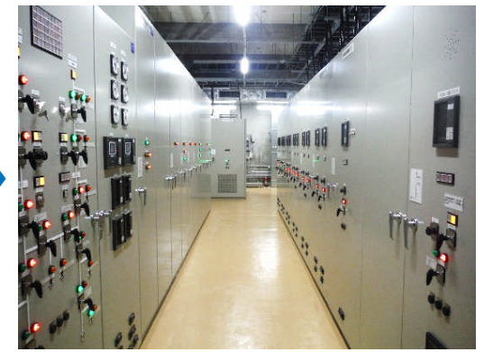
高圧配電盤（改修後）
