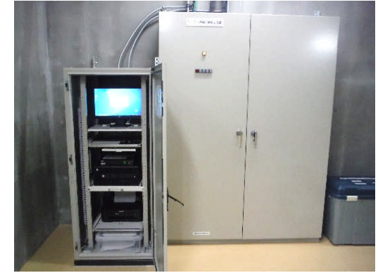
絶縁監視装置（改修後）
