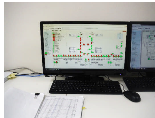
電力監視設備（改修後）
