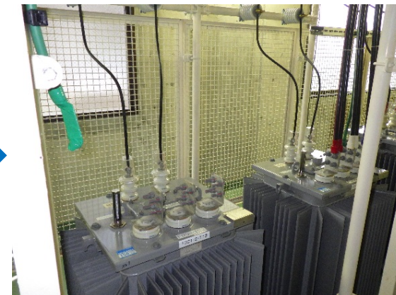
工学部1号館電気室（休止後）
