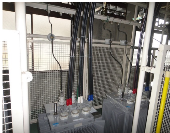
工学部1号館電気室（休止前）
