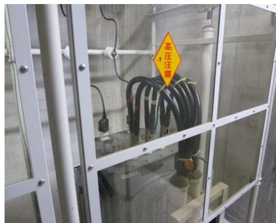
教育学部本館電気室（休止前）
