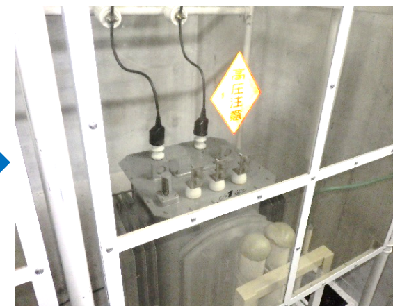
教育学部本館電気室（休止後）
