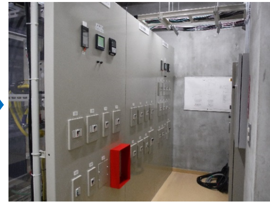
低圧配電盤（改修後）
