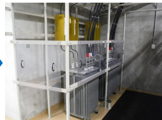
変圧器（改修後）
