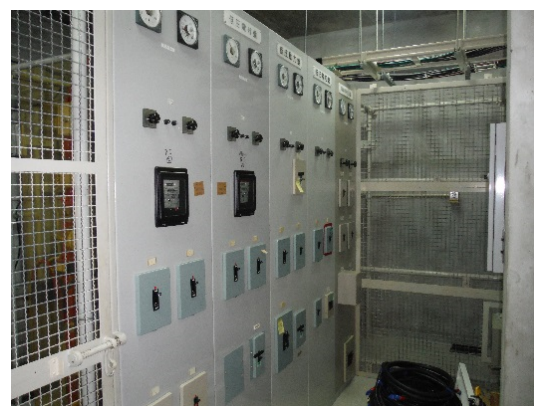
低圧配電盤（改修前）
