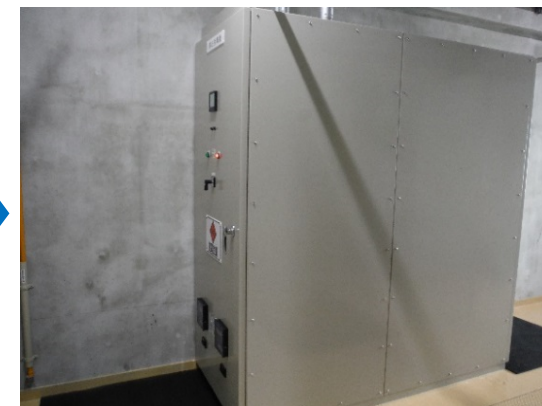
高圧受電盤（改修後）
