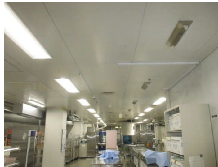
未消毒作業室 LED照明
