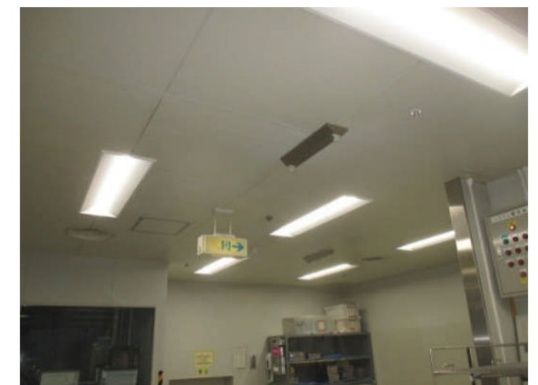
未消毒作業室 LED照明
