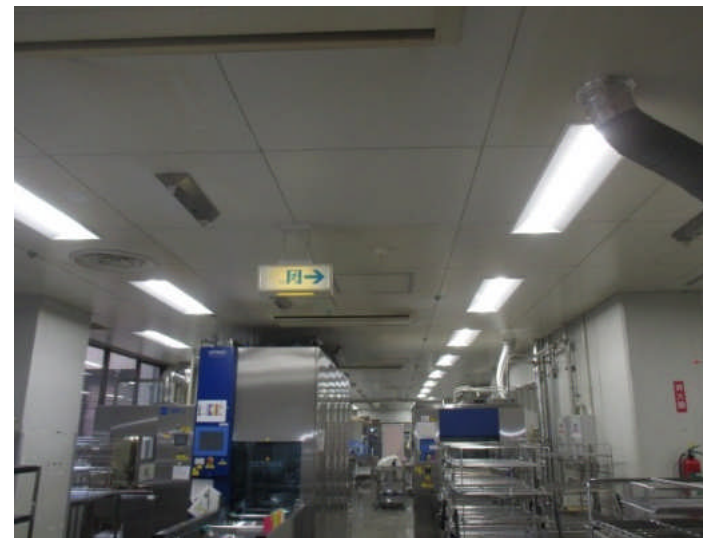
未消毒作業室 LED照明
