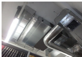
個別電気式空調機(書庫)
