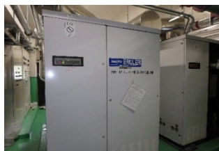
ガス焚き吸収式冷凍機
