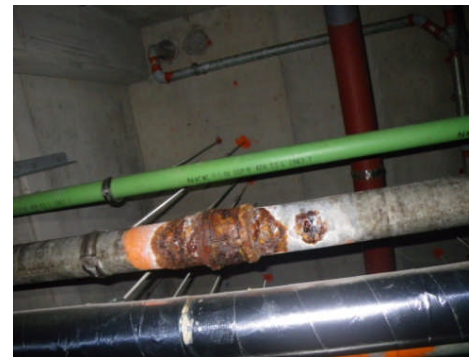
漏水部（老朽度→Bad）
