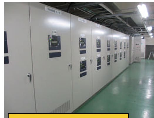
完成予想(高压配電盤)
