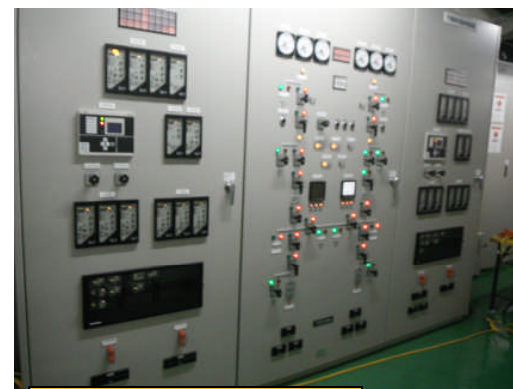
特別高圧操作盤
