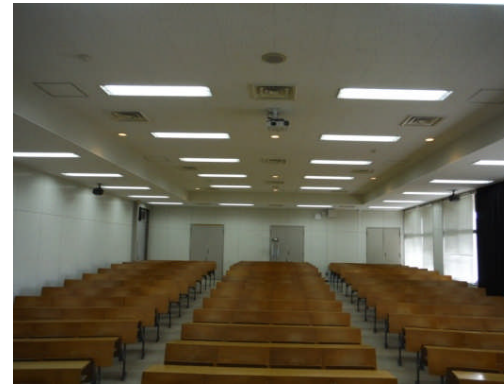
講義室 蛍光灯 (改修前)
