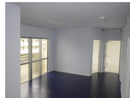
南星棟A（リビング）照明 更新後
