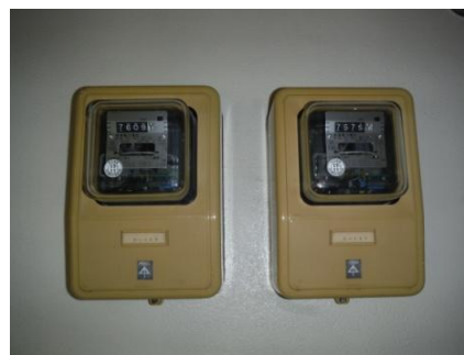
紫陽花棟 電力量計 更新前
