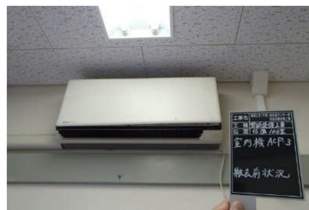
【極低温センター】 室内機 （更新前）
