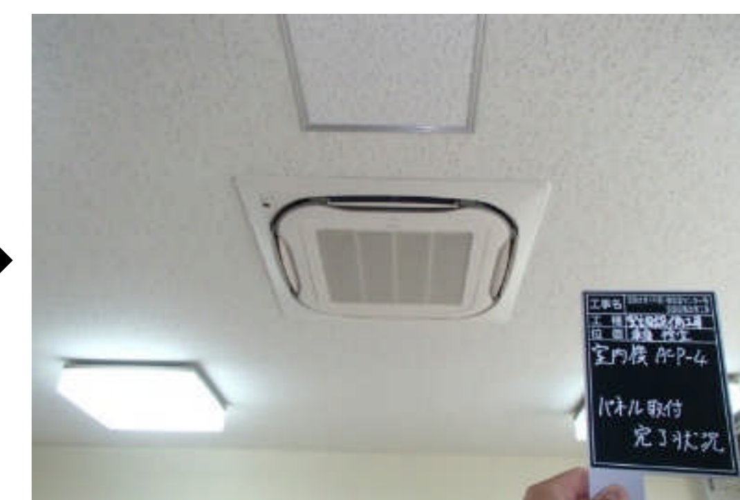
【車庫】 室内機 （更新後）
