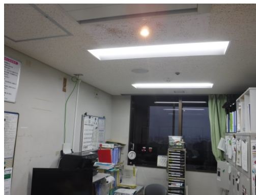
看護師控室 LED照明
