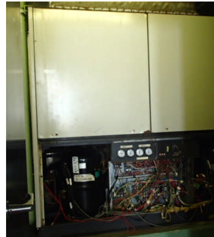
室内機（更新前）
