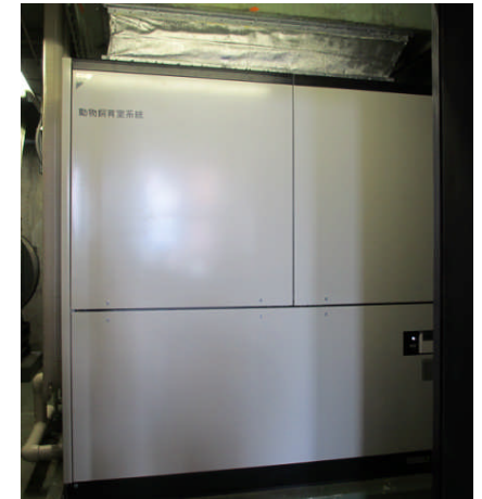
室内機（更新後）
