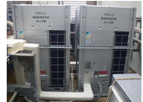
室外機（更新後）
