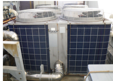
室外機（更新前）
