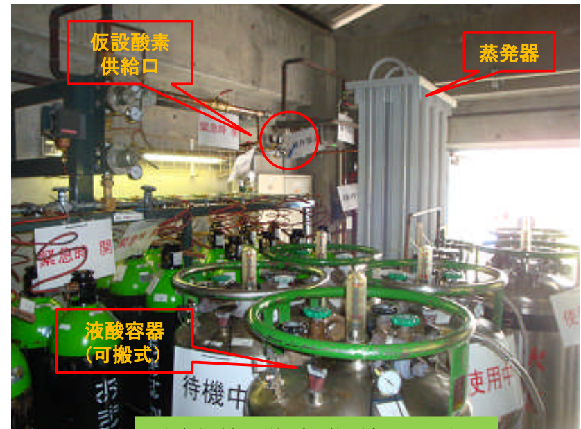
酸素供給設備（可搬式）設置状況
