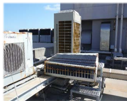
(台風時の被害) 空調室外機の転倒
