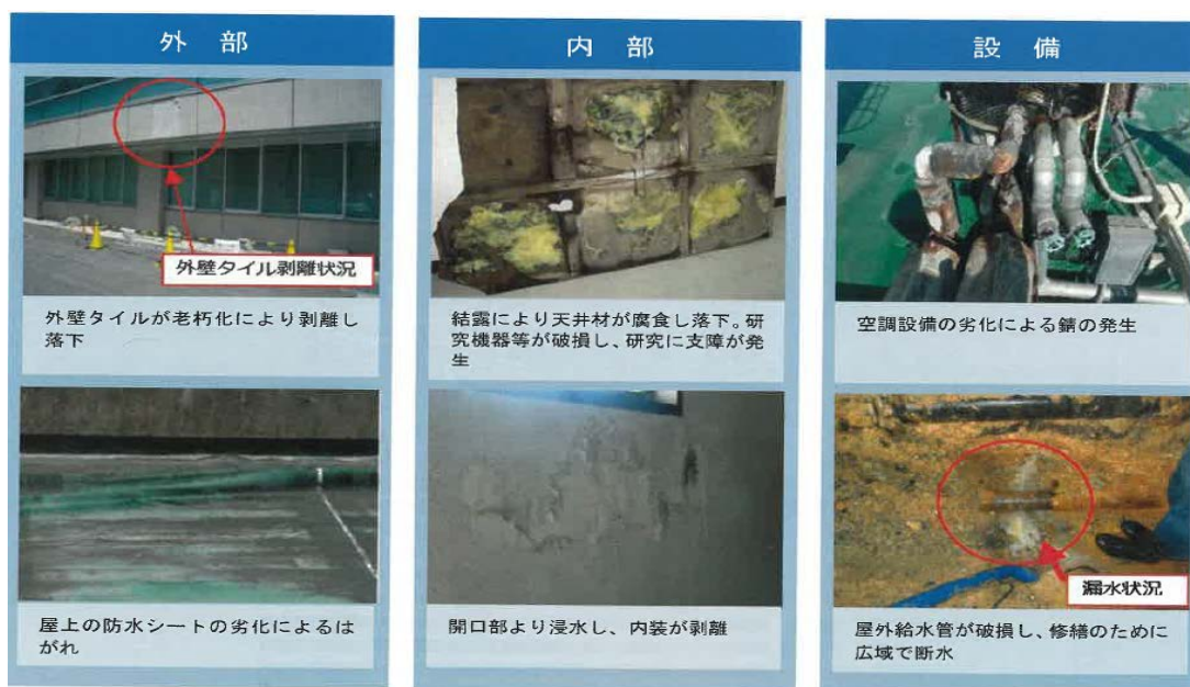
建物・基幹設備の劣化状況(文部科学省作成資料)
